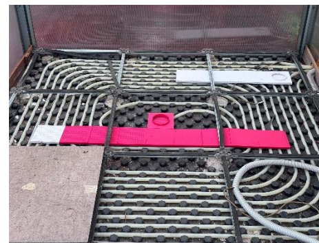
Impianto di riscaldamento a pavimento
